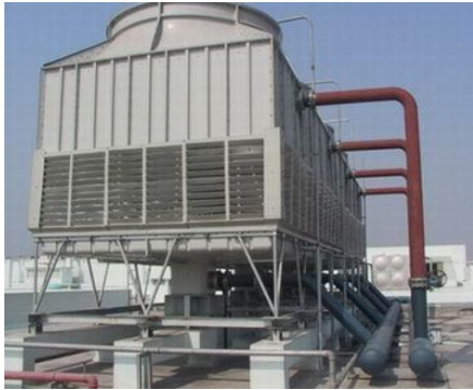
11 узлов сухой градирни: вентиляторы, фильтры, теплообменники и т.д.
