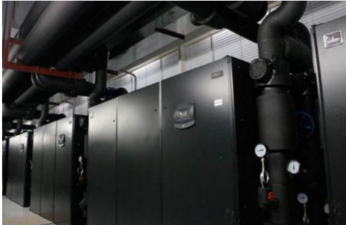
Шкафные кондиционеры расположены в машинных залах
