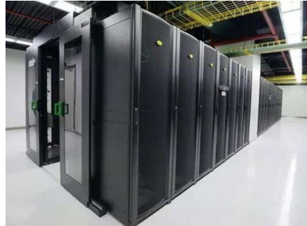
Внутрирядные кондиционеры расположены между ИТ-стойками
