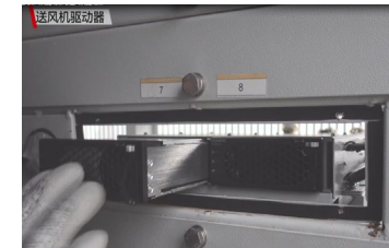
Силовые модули электропитания вентиляторов 1 мин на замену
